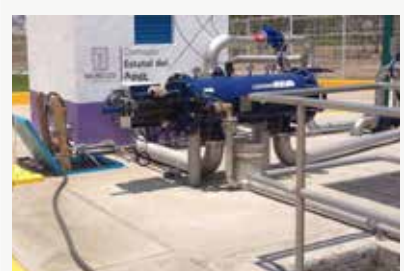
AZUD LUXON LXE 5400 S/6 Temoac Morelos WWTP
